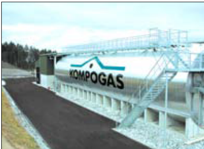
Joonis 3-13: Kompogas-meetodil töötav biogaasijaam; foto: Kompogas AG.
