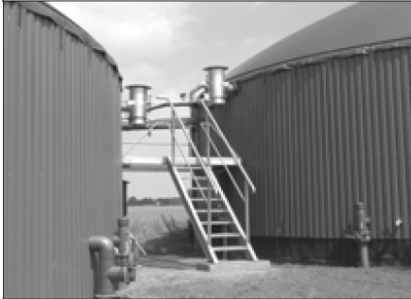
Joonis 3-28: Mahutitevaheline töölava koos ühendustorustiku ja ülerõhuventiiliga; foto: MT-Energie GmbH.
