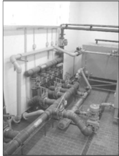
Joonis 3-20: Pumbad ühes biogaasijaamas.
